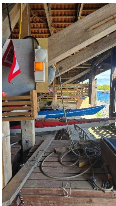
Lysafbryder ved port i bådehal
